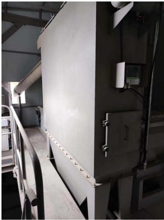
搅拌机除尘器
