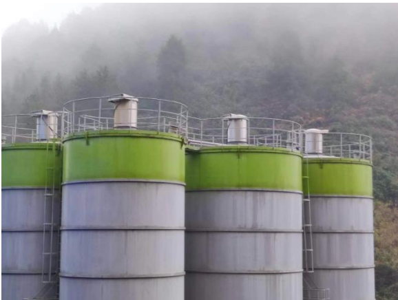
仓顶 WAM 除尘器
